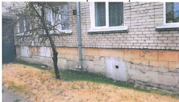
4.att. Plaisas, bioloģiski bojājumi betona apmalei. Ielas puse
