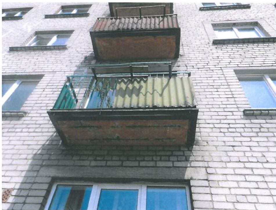
17.att. Bojāta balkona plātne
