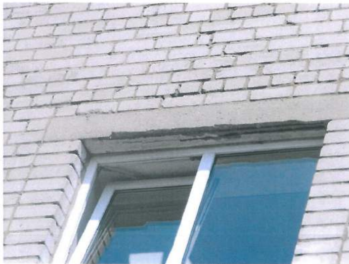
6.att Bojāta pārsedze. Sētas puse.
