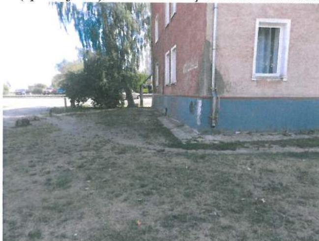
10.att. Nodrupusi betona apmale. Ēkas ZA stūris
