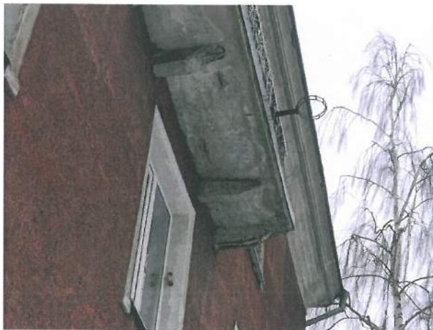
32.att. Balkons Nr.4. Bojātās siju konsoles.
