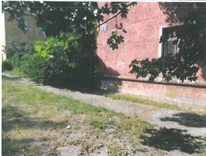
7.att. Ielas pusē esošais neatjaunotais virspamats
