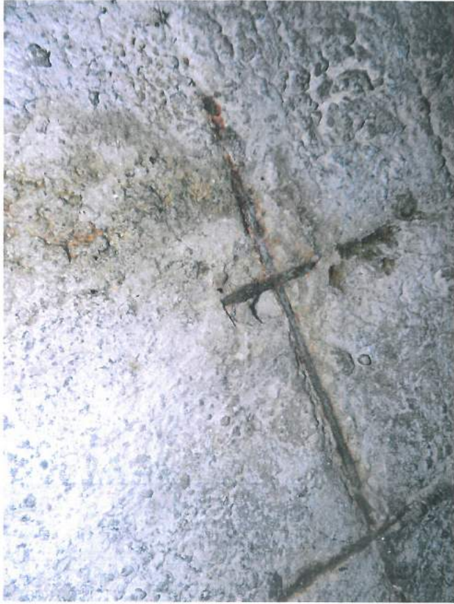
22.,23.att. Jumta panelu apakšējā virsma mitruma bojāta plašos laukumos: konstatētas plaisas, stiegru atsegumi, nomelnējums kondensāta mitruma iespaidā.
