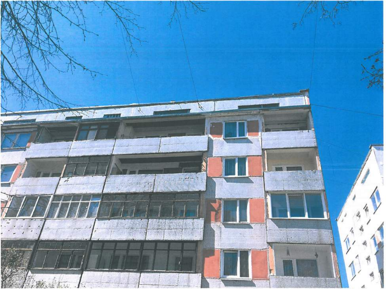
2.att. Ēkas galvenās fasādes labā puse ar sakaru kabeļiem; Redzami lodžiju margu panelu virsmas bojājumi.
