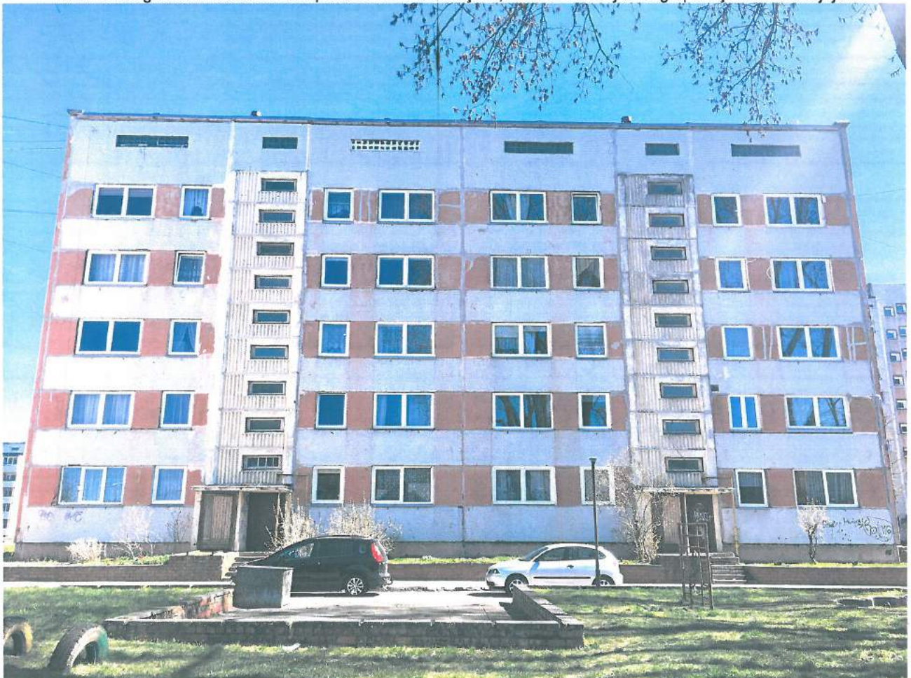
3.att. Pagalma puses fasāde. Pie ieejām redzami konteineru laukumi netiek izmantoti; fasādes apdare nolietojusies.
