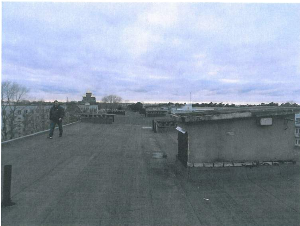
Ventilācijas izvadi un to nosedzošie jumtiņi remontējami.
