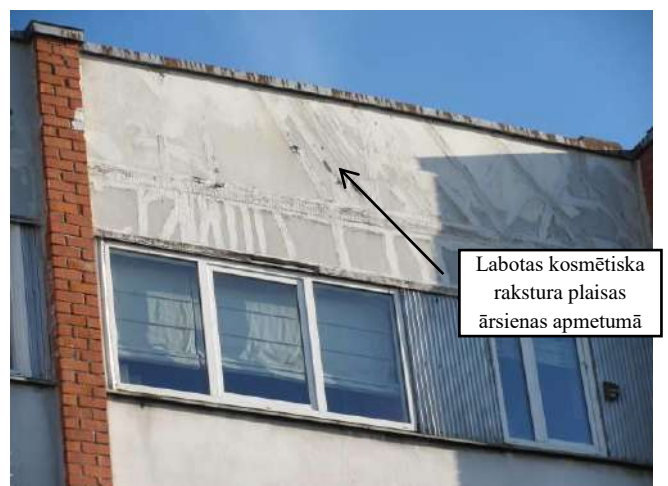
Sienas panelis 14. Ziemeļu fasādes fragments
