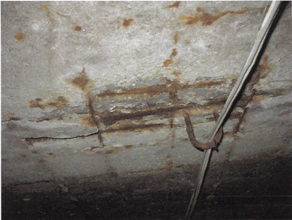
7. fotoattēls. Paneļa betona nošķēlumi, stiegru atkailināšanās un to korozija.
