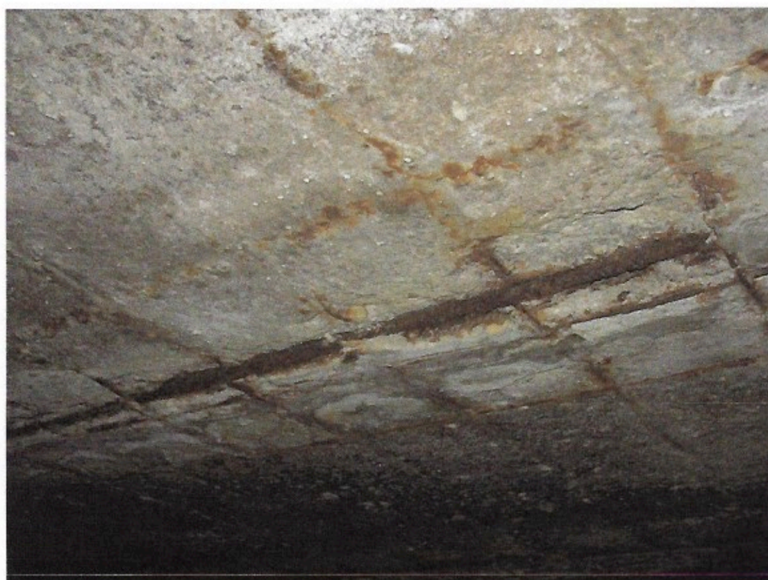
6. fotoattēls. Paneļa betona nošķēlumi, stiegru atkailināšanās un to korozija.
