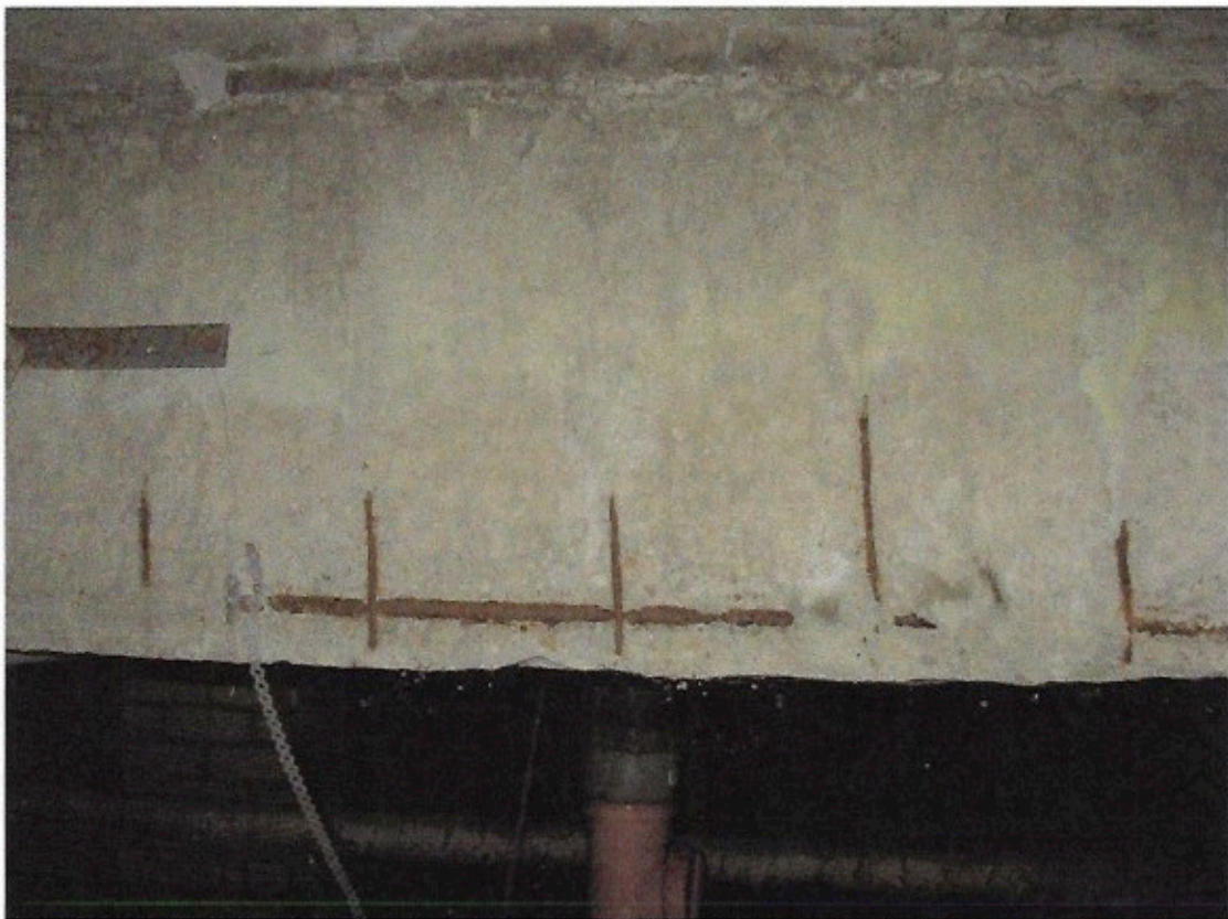
8. fotoattēls. Silesveida teknes stiegru atkailināšanās un to korozija.
