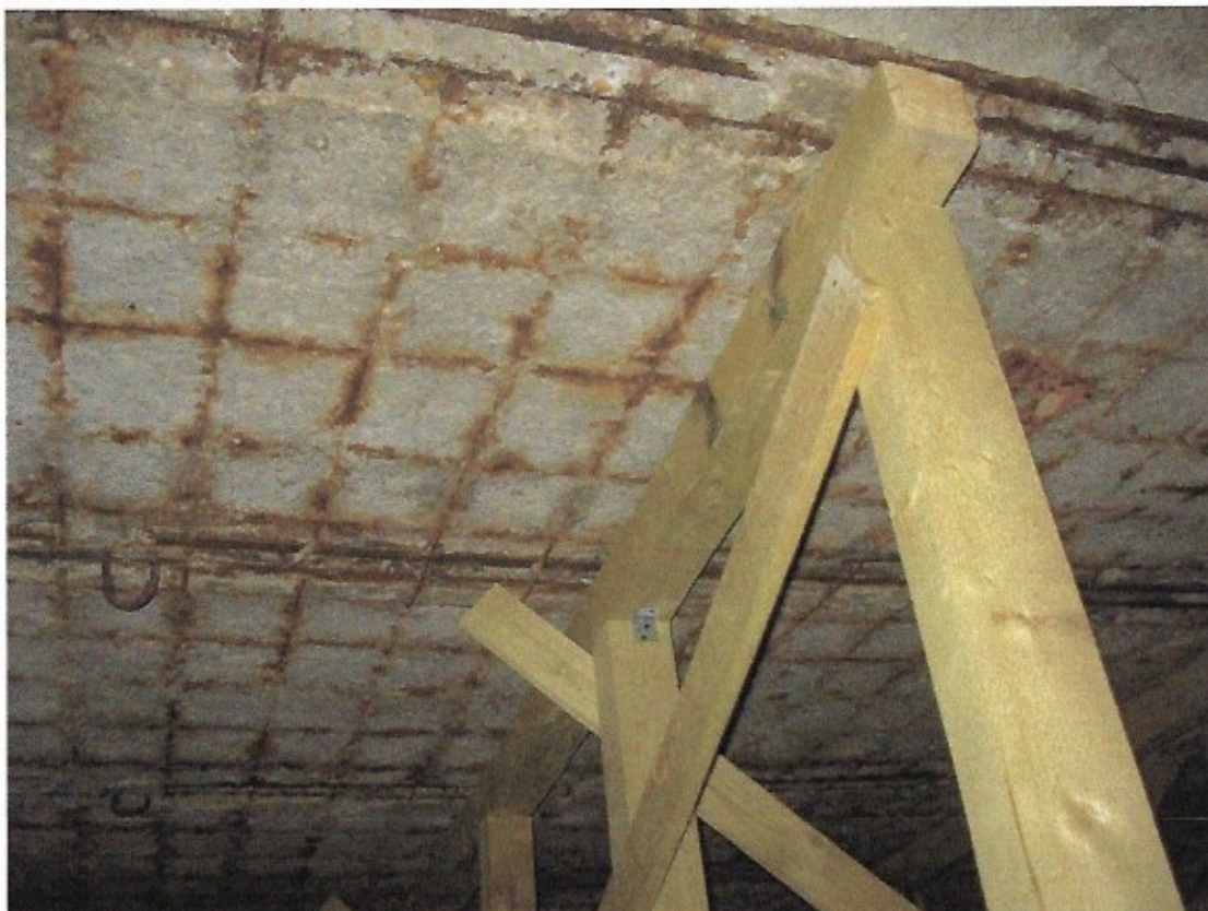
9. fotoattēls. Paneļa stiegru atkailināšanās un to korozija. Zem paneļa piebūvētā pagaidu nostiprinājuma konstrukcija.
