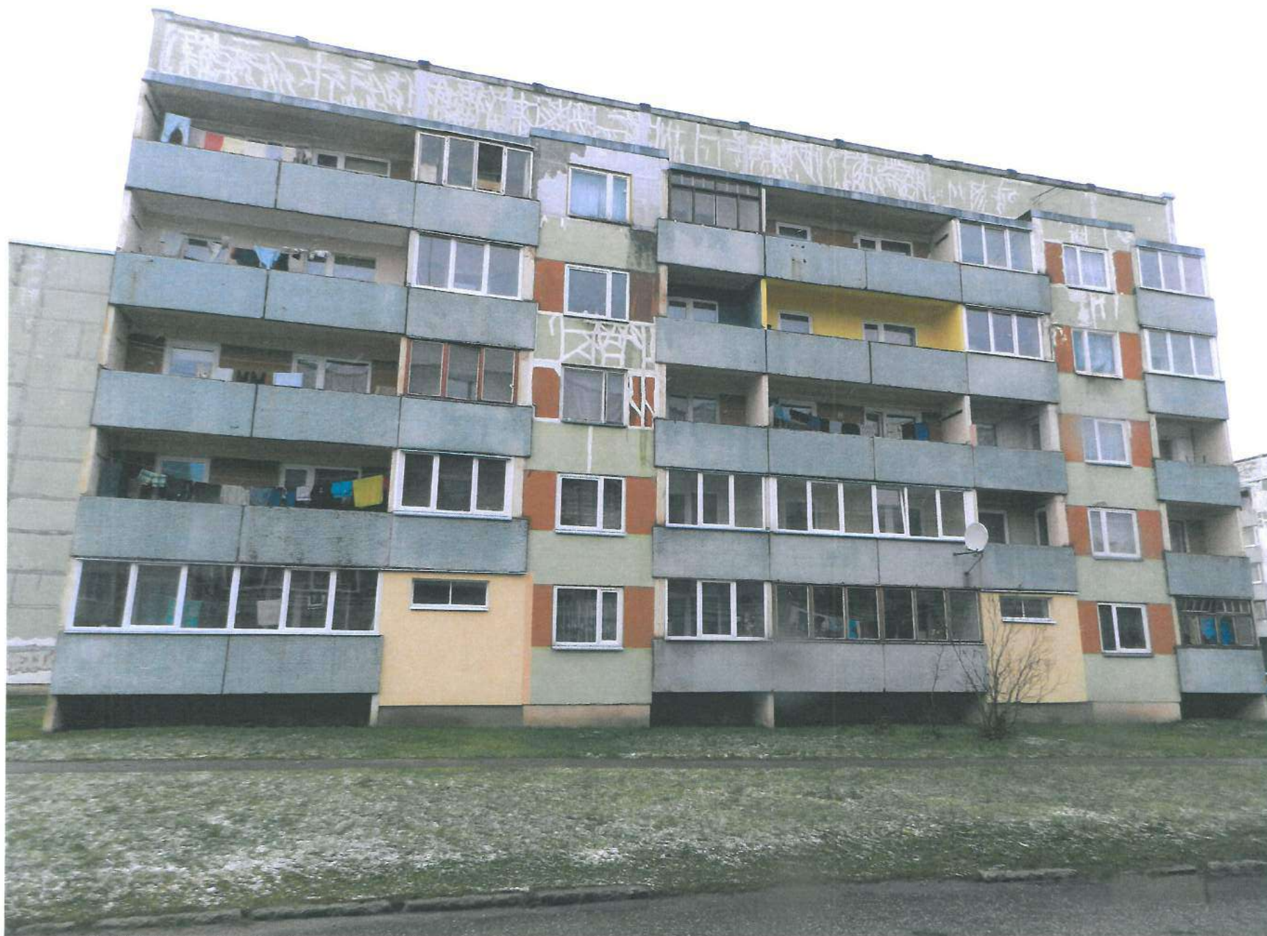
10.att. Dzīvojamā māja Aisteres ielā 7, Liepājā; redzama atsevišķa 2-sekciju ēkas daļas pagalma fasāde; ieejas no šīs puses aizdarinātas.
