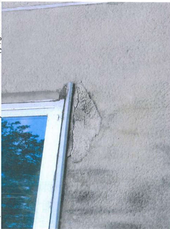
10.att. Ārsienu paneļos jāremontē izdrupumi, jāhermetizē šuves.
