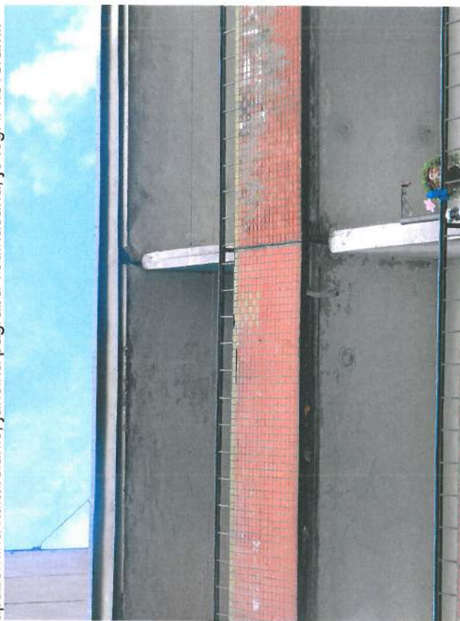
11.att. Konstatēti bojājumi (izdrupumi, robe) 5.stāva lodžiju jumta paneļeim..
