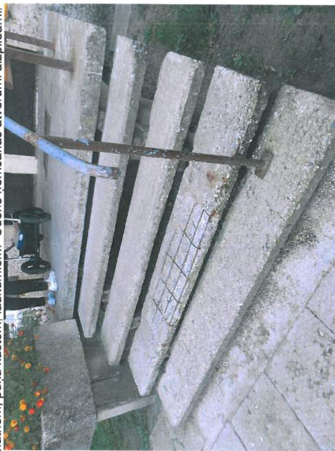
6., 7.att. Puķu kastes jāremontē; pakāpienu plātnēm un ieeju laukumiem jāatjauno betona virsma; nesošie elementi atrodas apmierinošā tehniskā stāvoklī.
