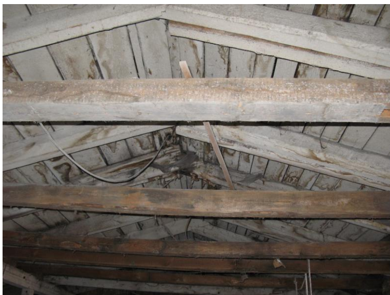
Daļēji bojāts dēļu klājs jumta korē.
