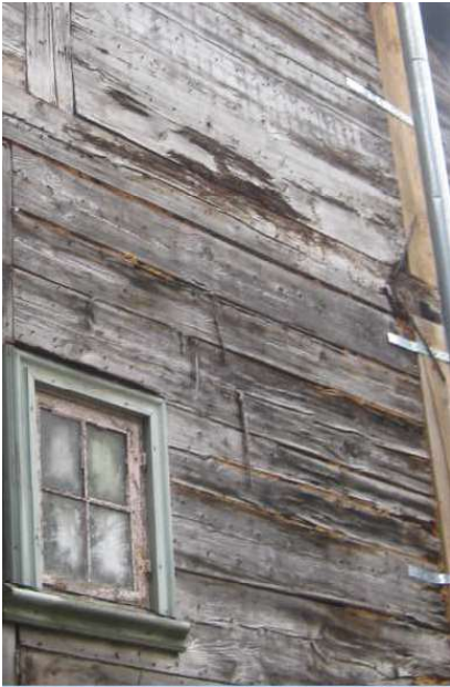
Foto Nr16 Pildījuma baļķu (guļšķautņu) bojājumi
