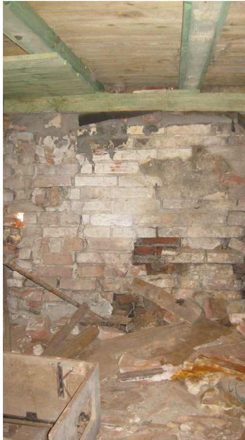
Foto Nr10 Ēkas cokolstāva mūris daļēji sabrucis
