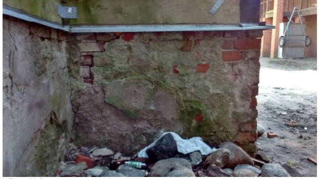
Foto Nr6 Ēkas pamatu virszemes daļa -plaisas mūrī
