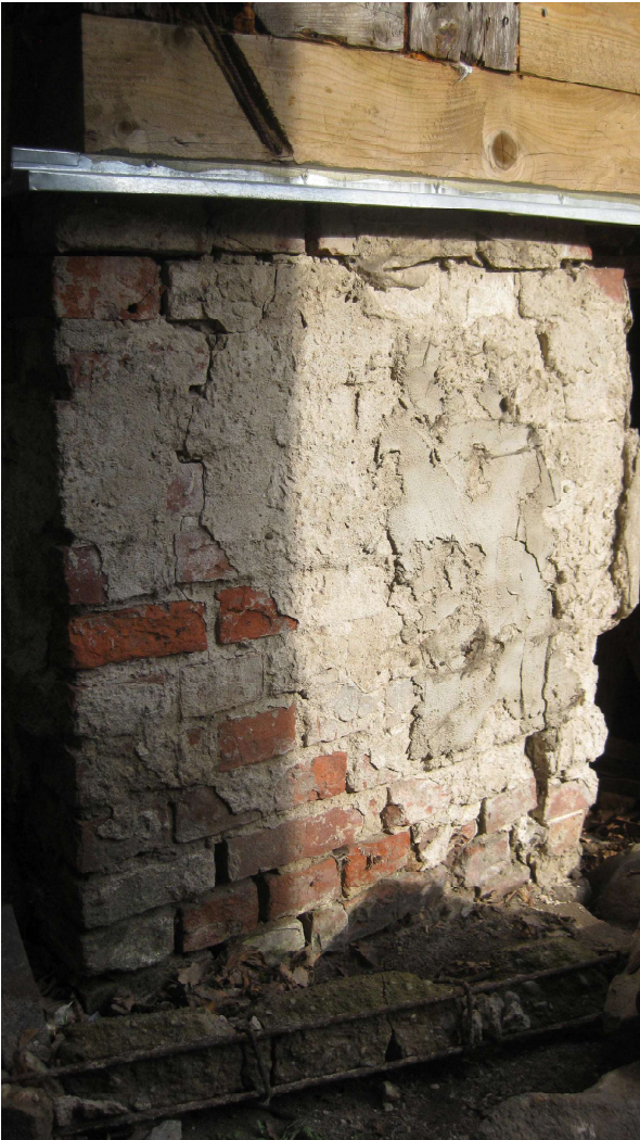
Foto Nr7 Ēkas pamatu virszemes daļa -plaisas mūrī
