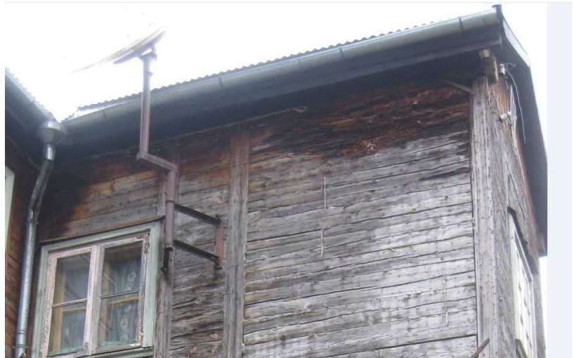
Foto Nr17 Pildījuma baļķu (guļšķautņu) bojājumi
