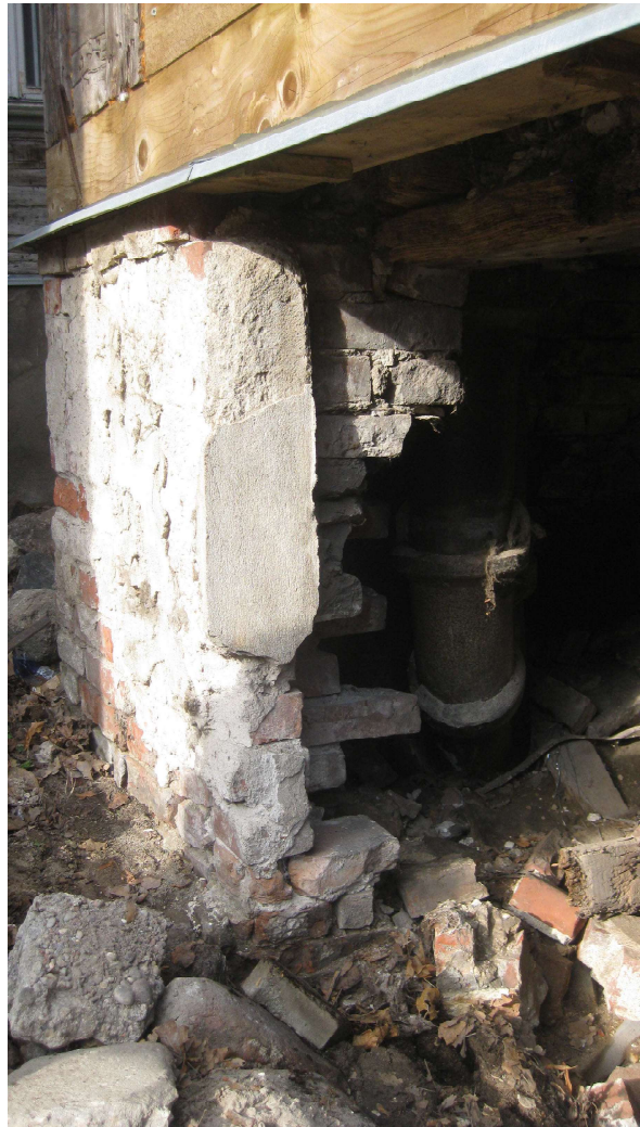
Foto Nr8 Ēkas pamatu virszemes daļa- mūris daļēji sabrucis
