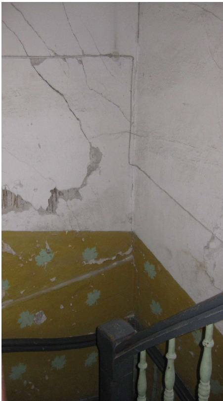
Foto Nr18 Nesošā siena kāpņu telpā- bojāts apmetums
