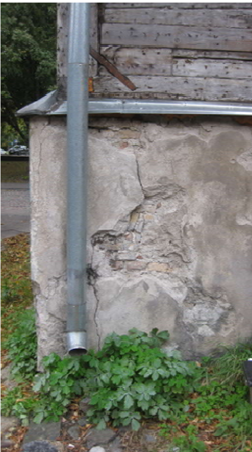
Foto Nr3 Ēkas pamatu virszemes daļa -plaisas mūrī
