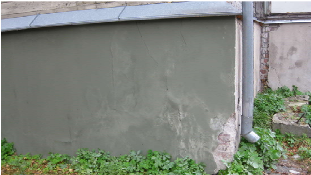
Foto Nr2 Ēkas pamatu virszemes daļa dienvidu fasāde –atdalījies apmetums , plaisas
