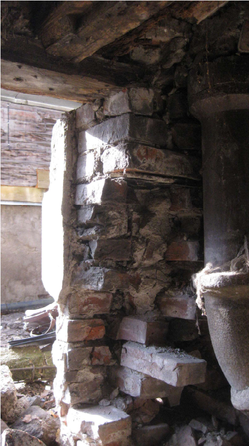
Foto Nr9 Ēkas pamatu virszemes daļa- mūris daļēji sabrucis
