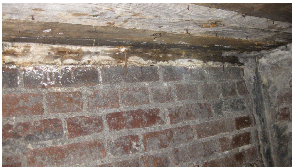
Foto Nr22 Koka konstrukcija virs mūra bojāta mitruma ietekmē
