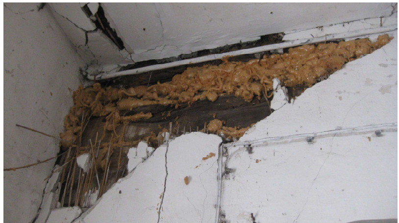
Foto Nr19 Nesošā siena kāpņu telpā- trupes bojāti guļšķautņi
