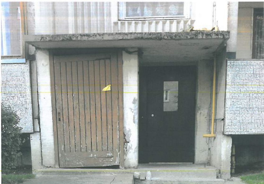
Ieeju jumtiņiem vietām bojāta betona apakškārta. Neskatoties uz to jumtiņa
