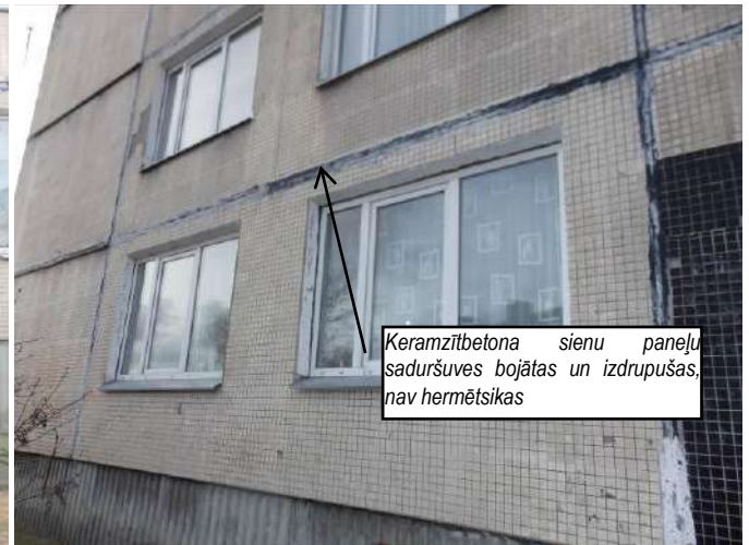
Bojātas sienu paneļu saduršuves 5. Austrumu fasādes fragments
