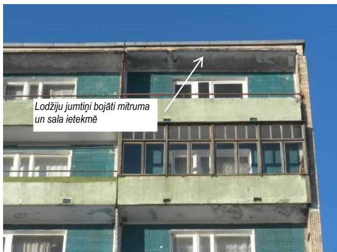
Bojāti balkonu pārseguma paneļi un lodžiju margu paneļi 10. Dienvidu fasādes fragments
