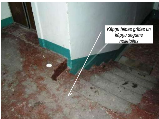
Kāpņu telpas grīdas segums nolietojies 45. Kāpņu telpa
