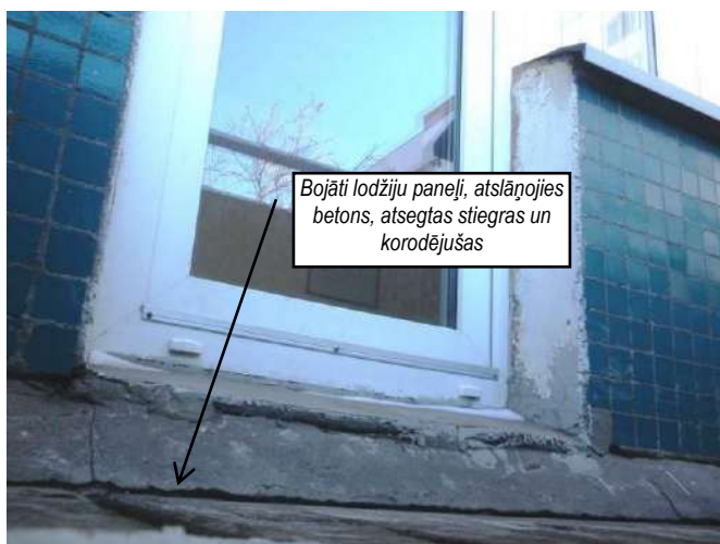
Bojāti lodžiju pārsegumu un margu paneļi. 14. Dienvidu fasādes fragments, lodžijas iekšskats
