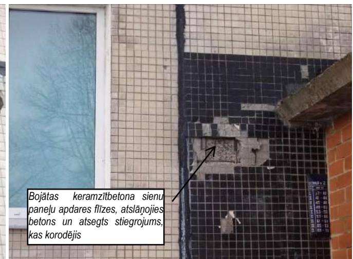
Bojāti sienu paneļi 7. Austrumu fasādes fragments
