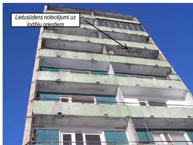
Bojāti lodžiju pārseguma paneļi. 12. Dienvidu fasādes fragments
