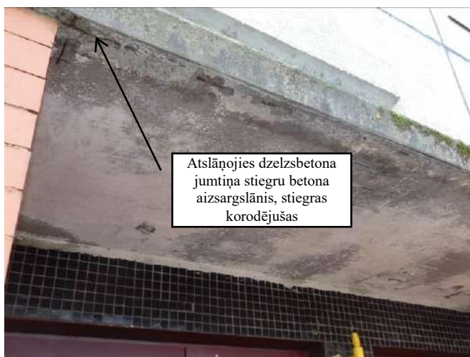
Bojāts ēkas ieejas jumtiņš, atslāņojies betons
