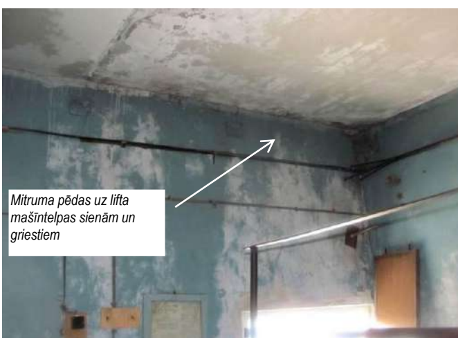
Bojātas lifta mašīntelpas sienas un griesti
