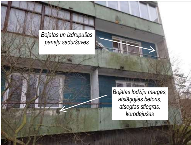
Bojātas balkonu margas, izdrupušas sienu paneļu saduršuves, nav hermētiskas 25. Ziemeļu fasādes fragments
