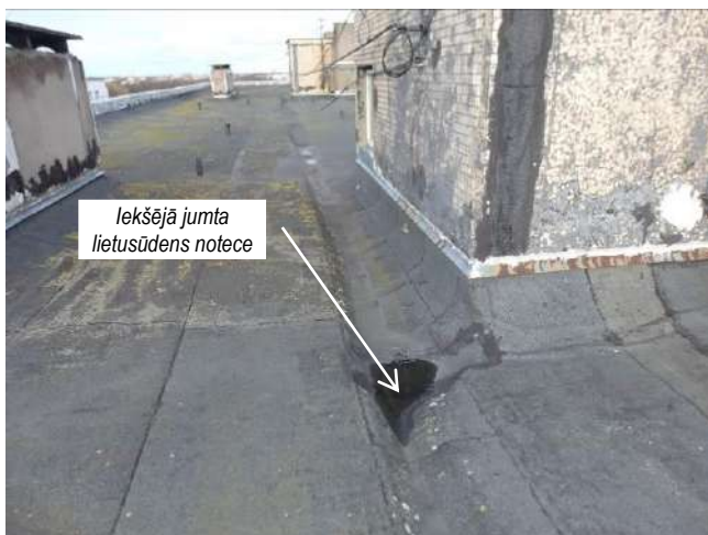
Jumta iesegums bojāts, devītā stāva dzīvokļos lietusūdens notecējumi
