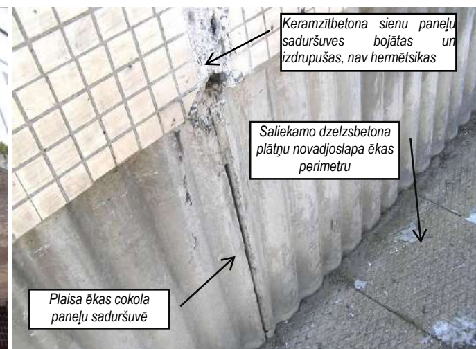
Bojātas sienu paneļu saduršuves, plaisas ēkas cokola paneļu sadurvietās.
