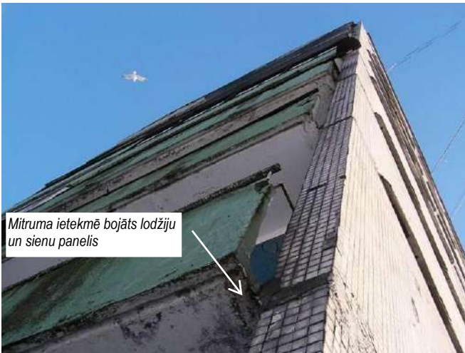
Bojātas lodžiju margas, lodžiju pārsegumu paneli, sienu paneli 27. Ziemeļu fasādes fragments
