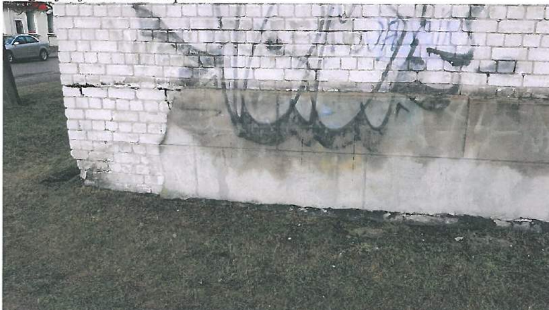
4.att. Plaisas, bioloģiski bojājumi cokolā. Ielas puse
