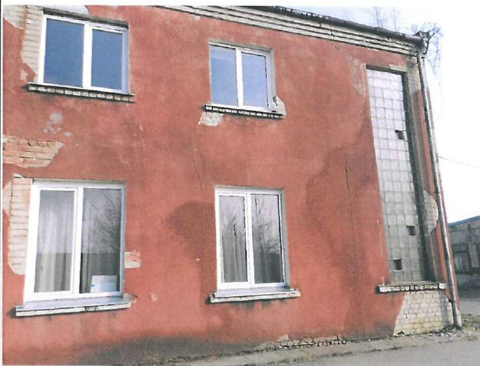
4.att. Plaisas, bioloģiski bojājumi cokolā. Ielas puse
