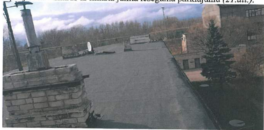
20.att Ventilācijas izvadi
